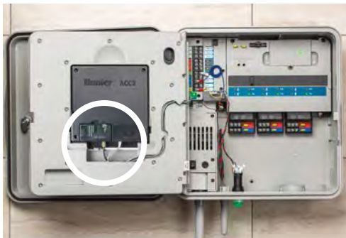
ACC2 vezérlő beépített A2C-CELL-E modulal
